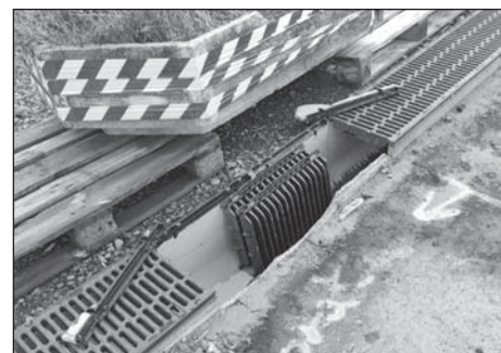
Poškozený odvodňovací žlab (foto Jan Bureš)
