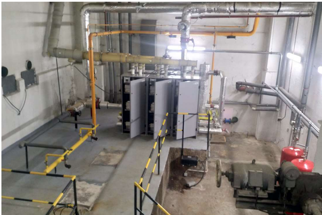
Obr. 4: Fotografie interiéru kotelny Žižkovo náměstí
