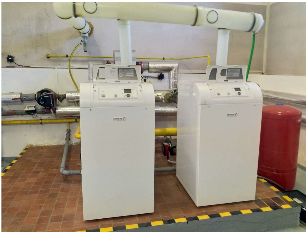
Obr. 8: Fotografie interiéru kotelny Ke Stadionu
